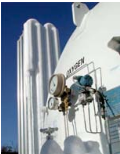
Ilttank og fordamper på Stavnsholt Renseanlæg
